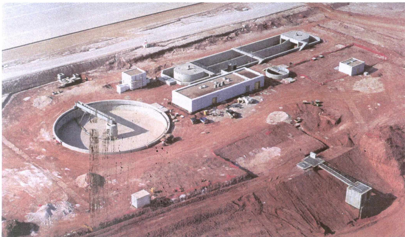
Εγκαταστάσεις Βιολογικού Καθαρισμού
