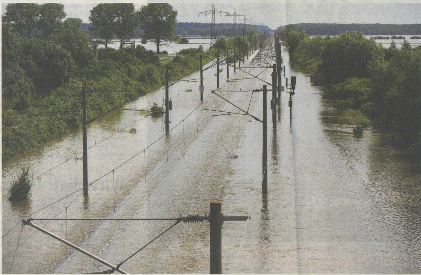
Wasserstraße: Eine überflutete Bahntrasse in Sachsen-Anhalt
